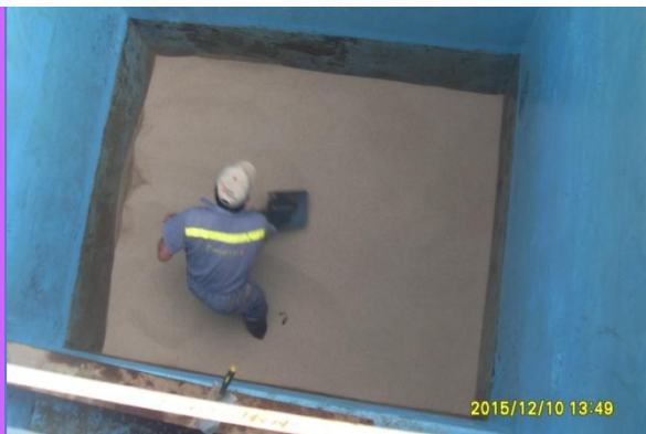
Cambio del Material Filtrante (arena y antracita)
