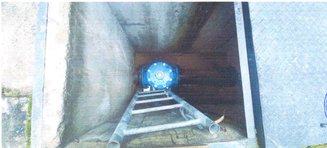
Macro medidor de 8" instalado en el Reservorio R2
