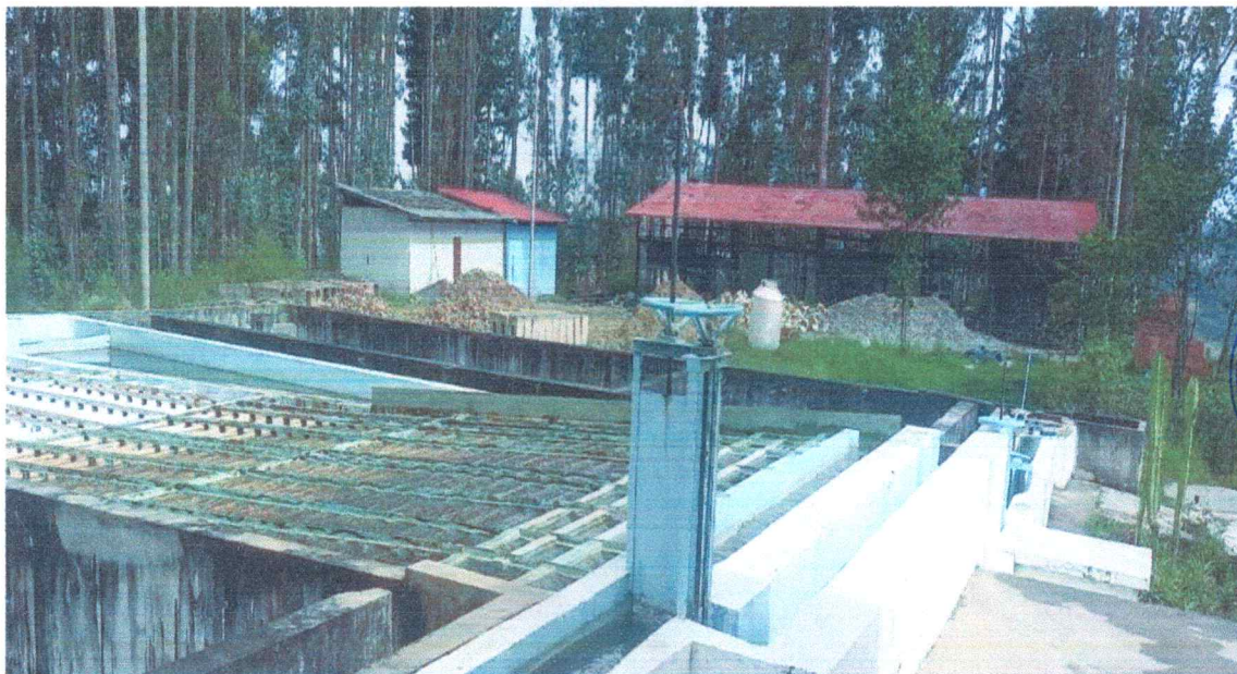
Floculador hidráulico de flujo horizontal
