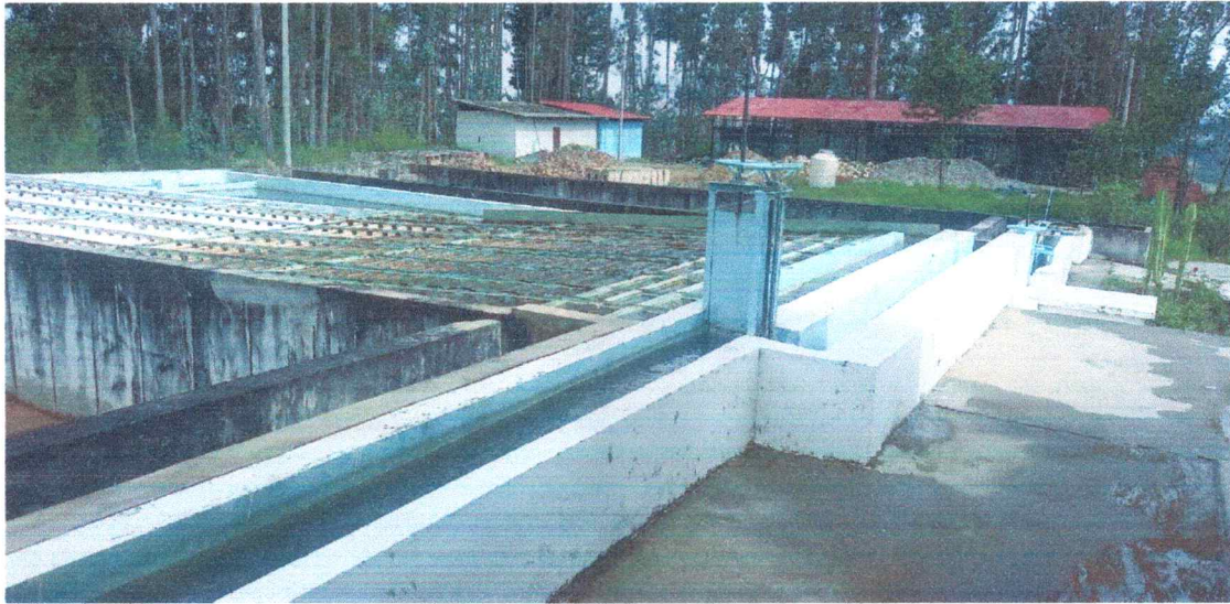
Planta de tratamiento de Agua Potable EPS EMUSAP S.A.
