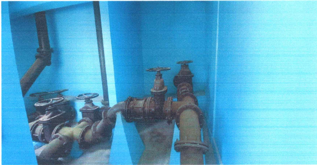
Caseta de válvulas de Reservorio R2
