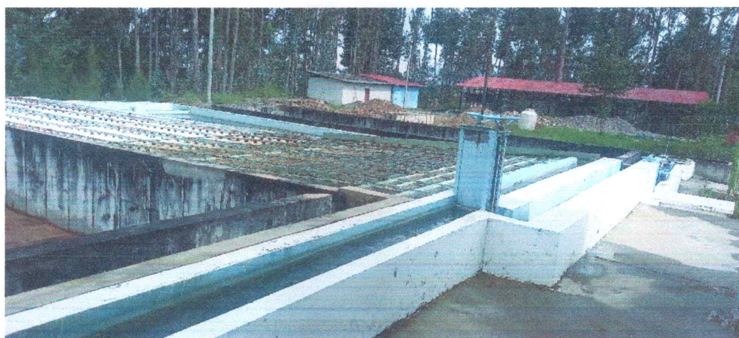
Planta de Tratamiento de EMUSAP S.A.
