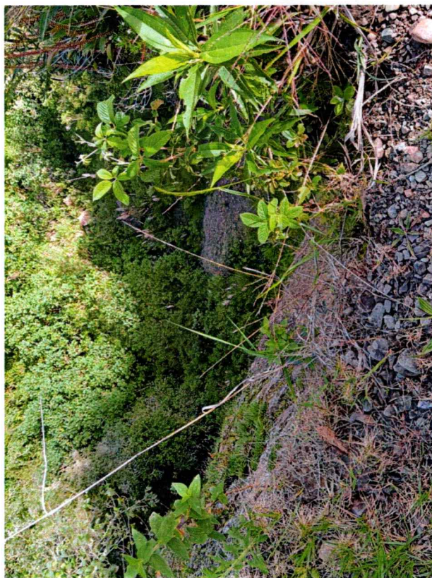
Imagen 27. Tubería Conducción Ashpachaca – sector Lache Monte
