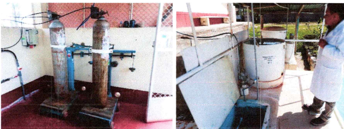
FOTO N° 06 SISTEMA DE CLORACIÓN CON GAS Y TANQUES DE DOSIFICACIÓN CON HIPOCLORITO DE CALCIO
